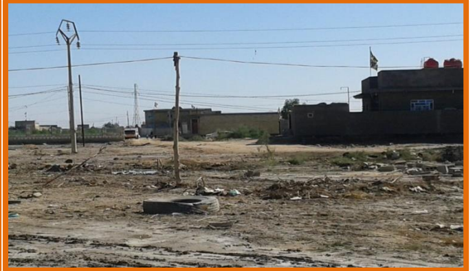
الصورة (٧) الاسلاك الكهربائية في مناطق التجاوز
